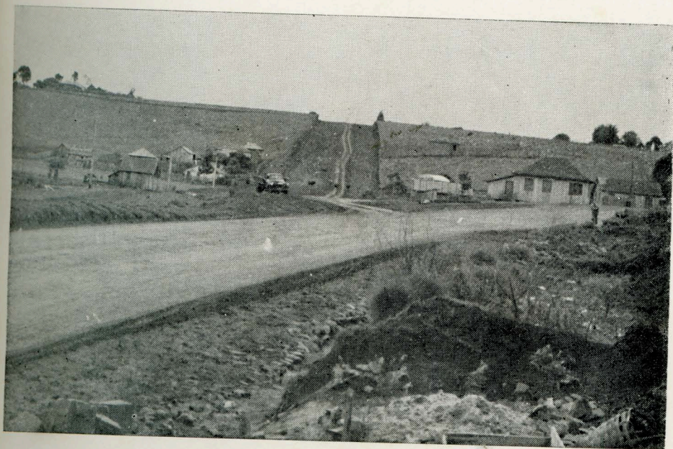
Início da Construção do prolon- gamento da Avenida Capitão Jo- vino, na Vila Petrópolis.
