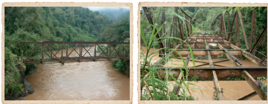
A ponte em 17/07/2015, com 81 anos e, abandonada
