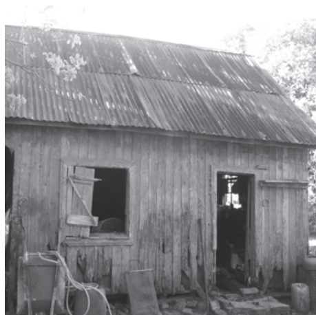
No galpão em plena decomposição, o que não falta é cupim.
