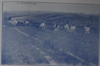
Fig. 15 — Turma de conservação, reparando trechos da estrada que liga esta cidade á colonia d. Ernestina
